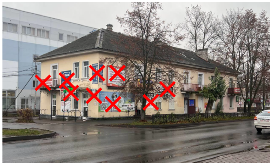
Баннеры на фасаде и ограждении балкона Вывеска на козырьке Сплошная заклейка окон Хаотично расположенное на фасаде оборудование
